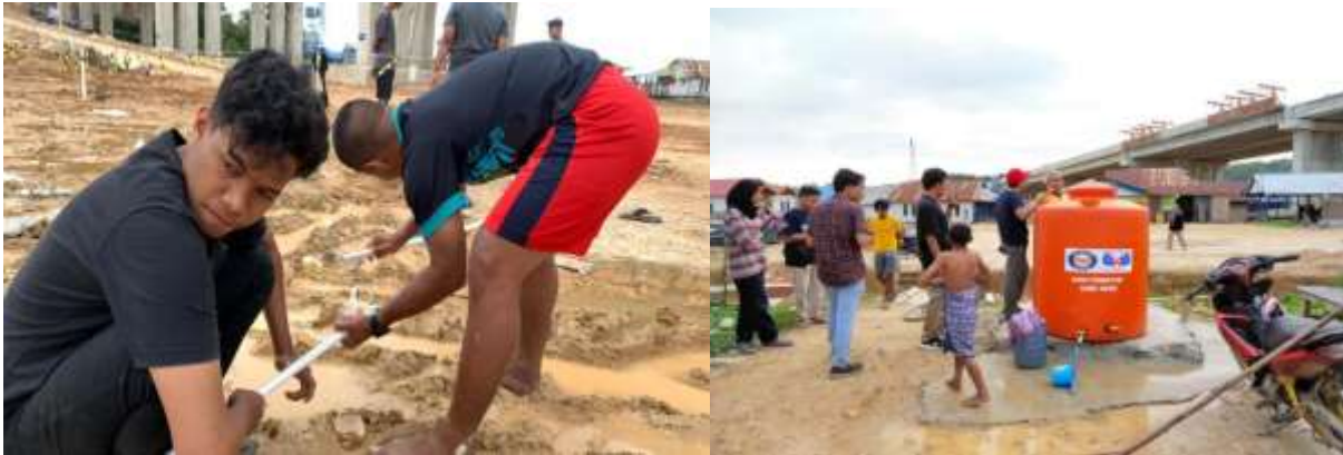
Gambar 3. Instalasi pipa dan tandon air bersih di lokasi program
